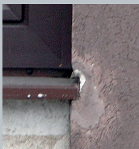
Mauerwerk mit Frostschaden ohne DRYPRO Abschlussprofil
